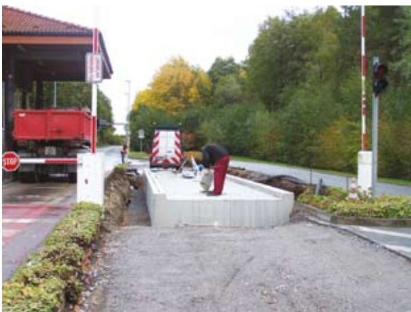
Im Oktober wurde die vierte Waage im Eingangsbereich des Entsorgungszentrums installiert.
